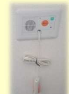
居室緊急通報装置 (ナースコール)
